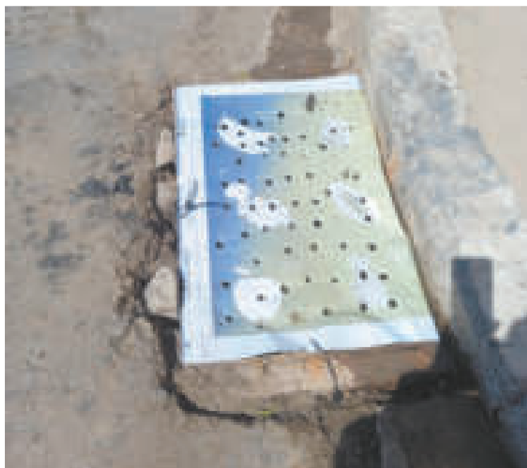
Una boca de tormenta reparada de forma artesanal por los vecinos de Vino Tinto.
