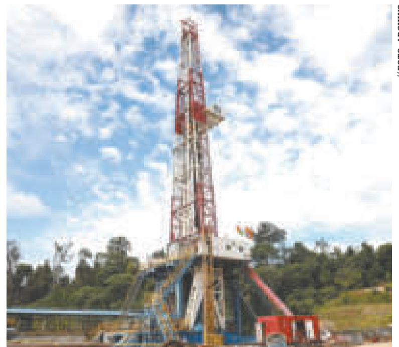
Pozo administrado por YPFB.
