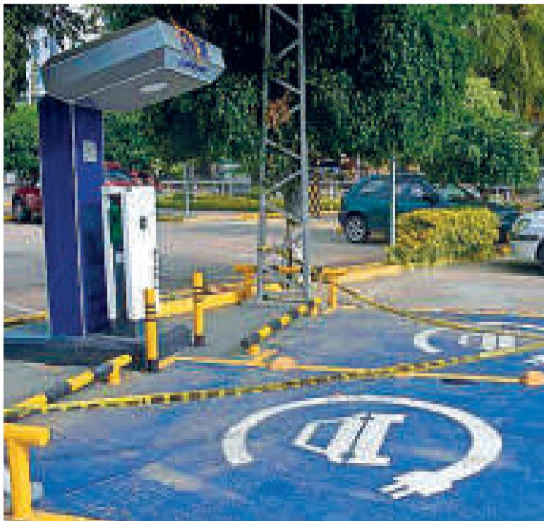
Una de las electrolinerías en el municipio de Cochabamba.
