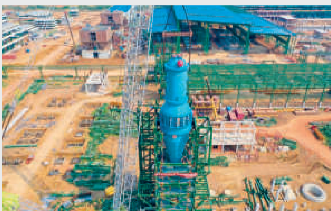
El reactor montado en la torre de la Planta de Reducción Directa de Hierro (DRI).
