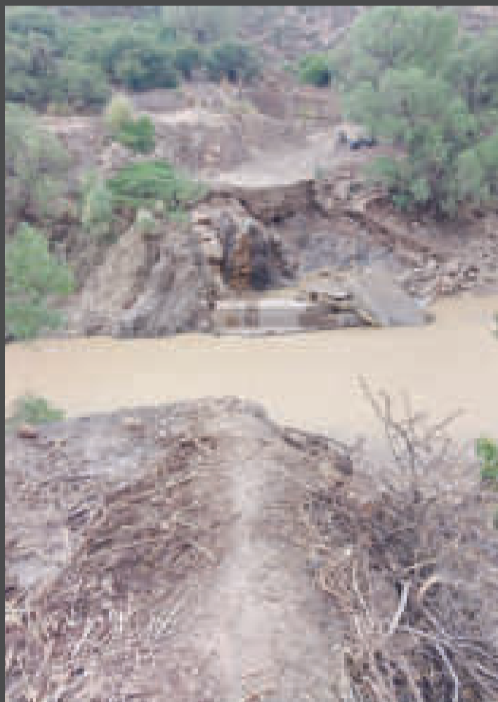
La plataforma de un puente, en Cotagaita, colapsó ante la fuerza de las aguas.
