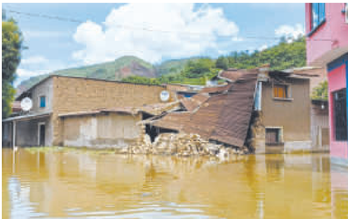
Una vivienda en Tipuani no soportó la fuerza del agua y se desplomó.
