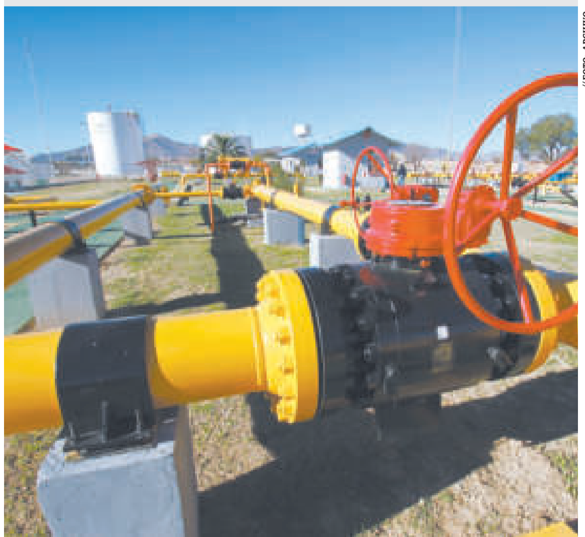
Ductos de YPFB para el transporte de hidrocarburos.
