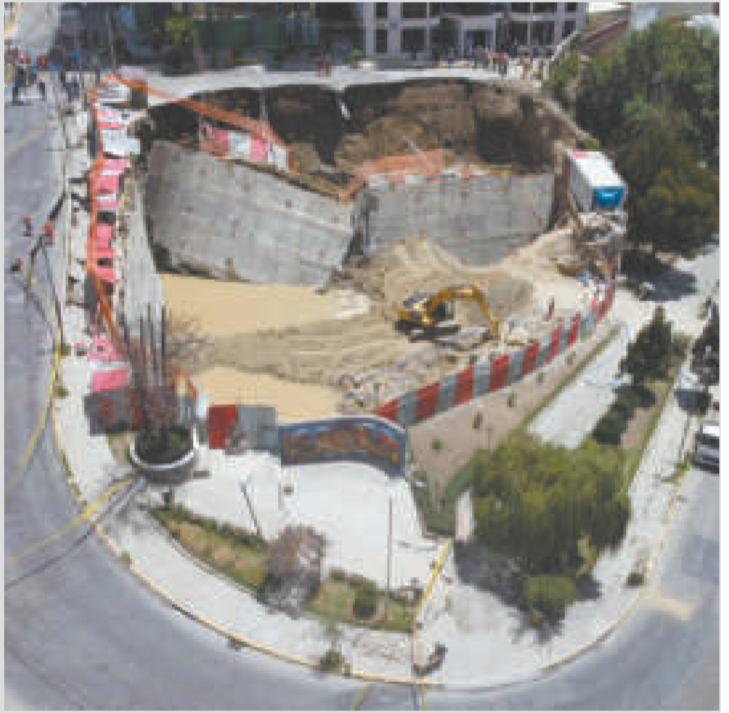
El hundimiento y colapso de plataforma.
