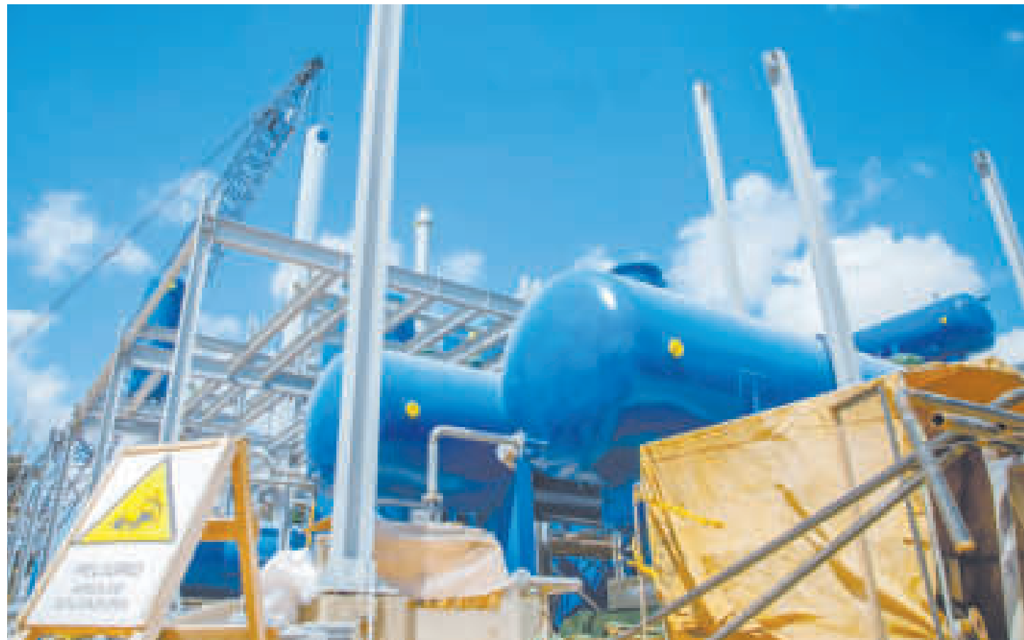
Equipos de la Planta de Biodiésel I, en Santa Cruz.
