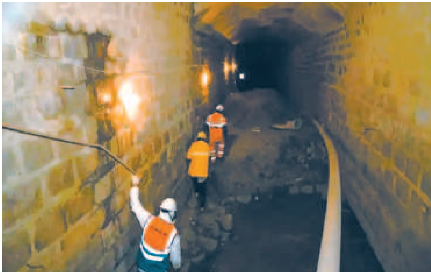
Las últimas inspecciones técnicas al embovedado del río Choqueyapu mostraron problemas.
