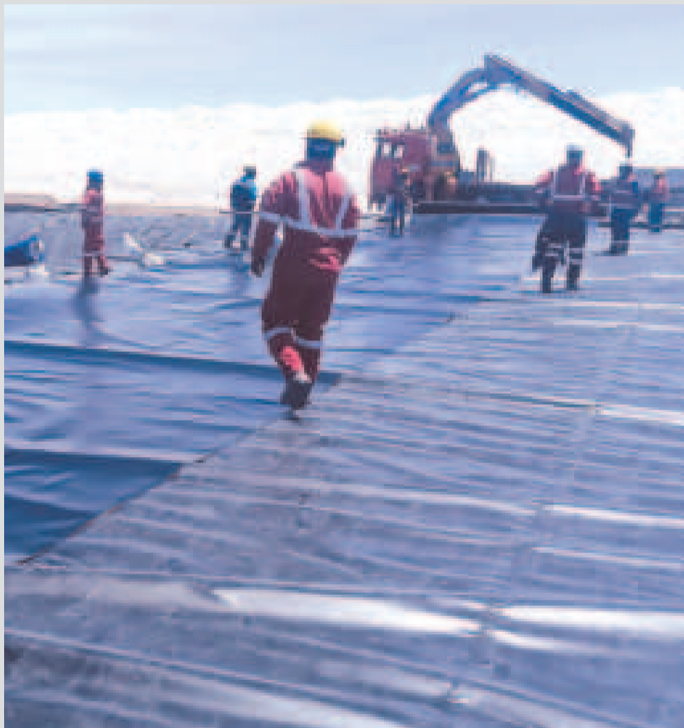
Trabajadores de YLB en una de las piscinas del Complejo Industrial de Litio en el salar de Uyuni.
