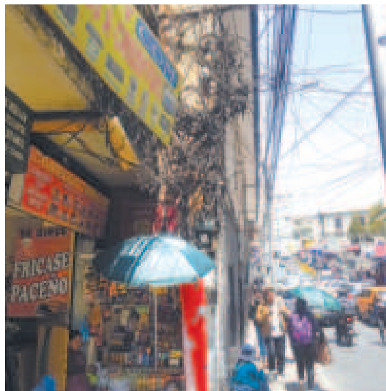
El centro paceño está inundado de cables en desuso.
