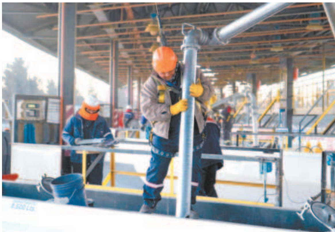
Las operaciones de despacho de combustibles en las plantas de almacenaje.
