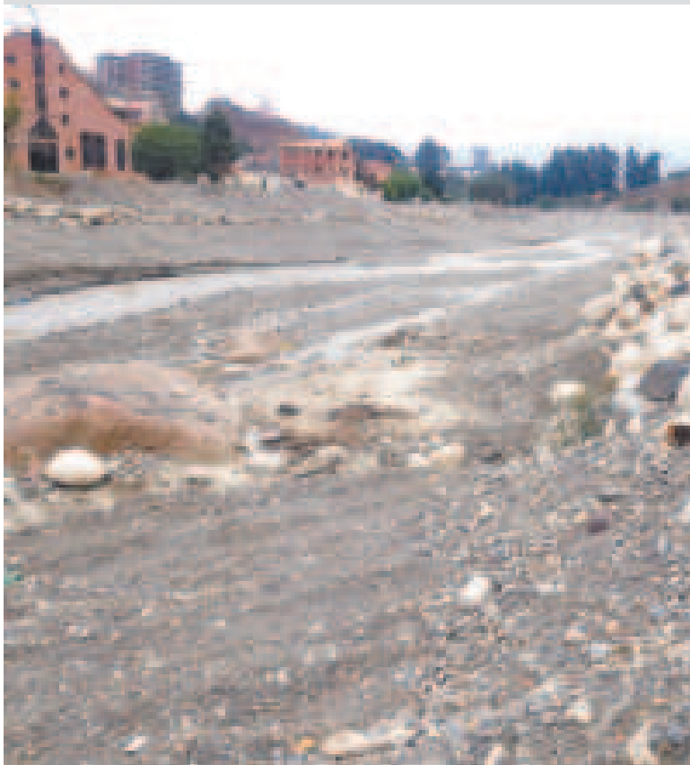
Existe el riesgo latente de desborde del río La Paz.
