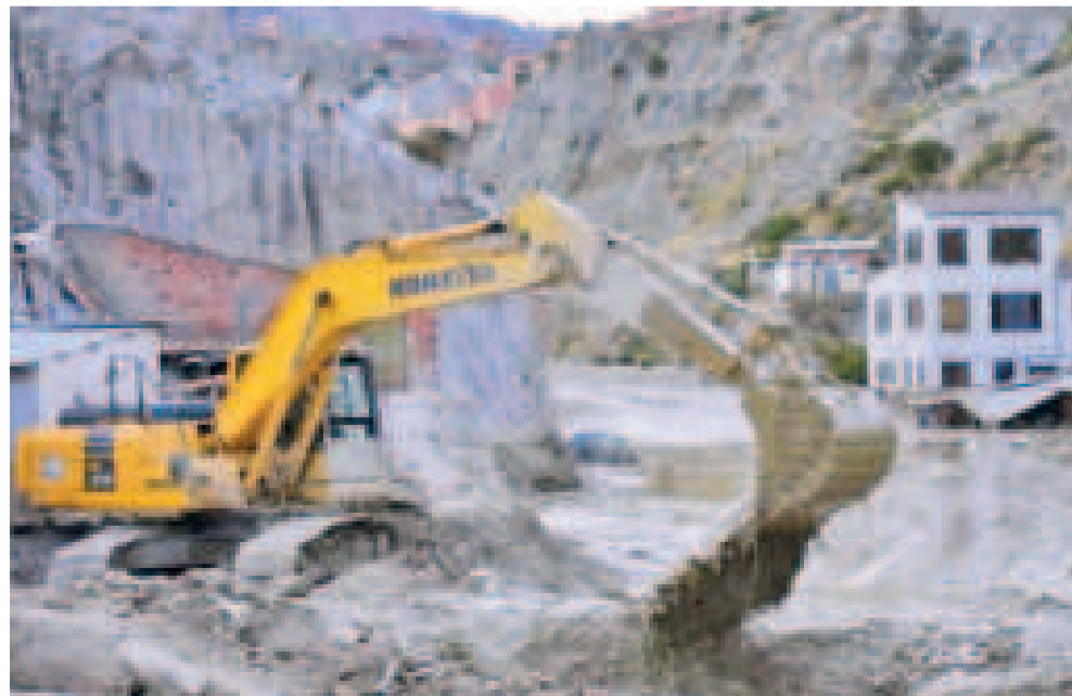
Maquinaria pesada en medio del lodo producto del rebalse del río Pasajahuira.
