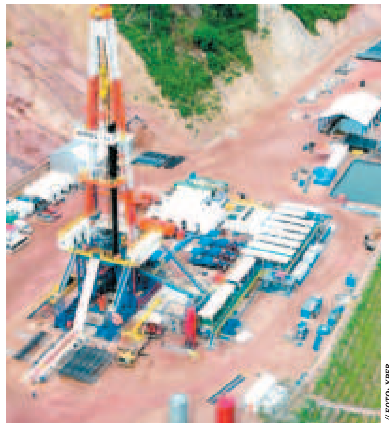
El pozo Iñau-X3D, ubicado en Chuquisaca, es parte del PRU de YPFB.
