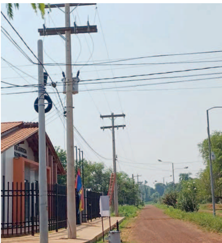
Parte de una infraestructura eléctrica.
