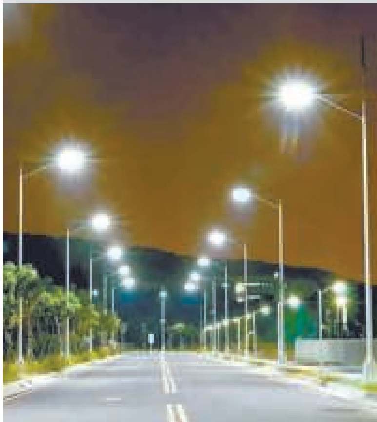
Una vía iluminada con focos LED en Trinidad.
