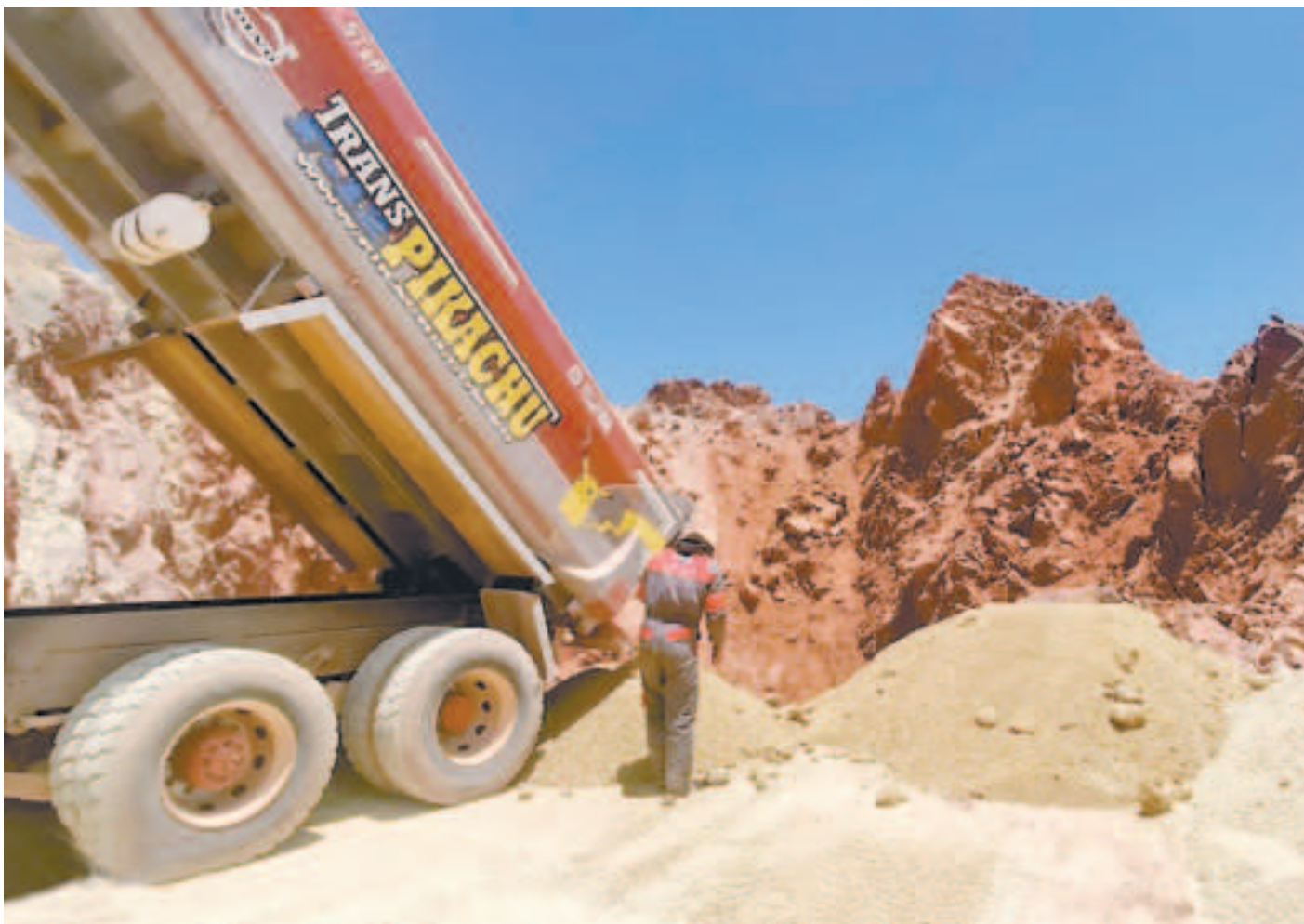
El relleno de uno de los hundimientos del Cerro Rico.
