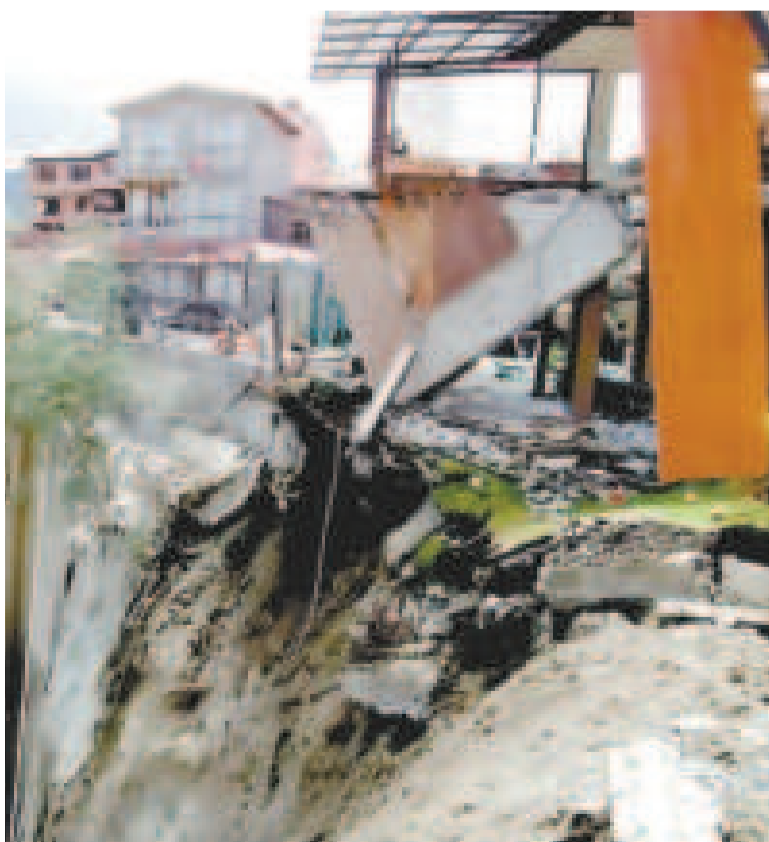
Casa afectada por el derrumbe en la zona de Jupapina, en Mallasa.
