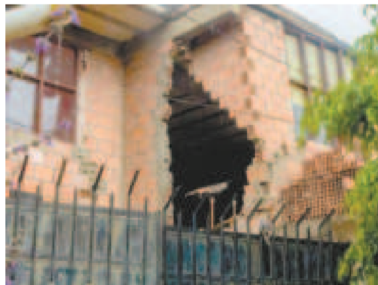
Una vivienda derruida en la OTB Nuevo Amanecer en Cochabamba.
