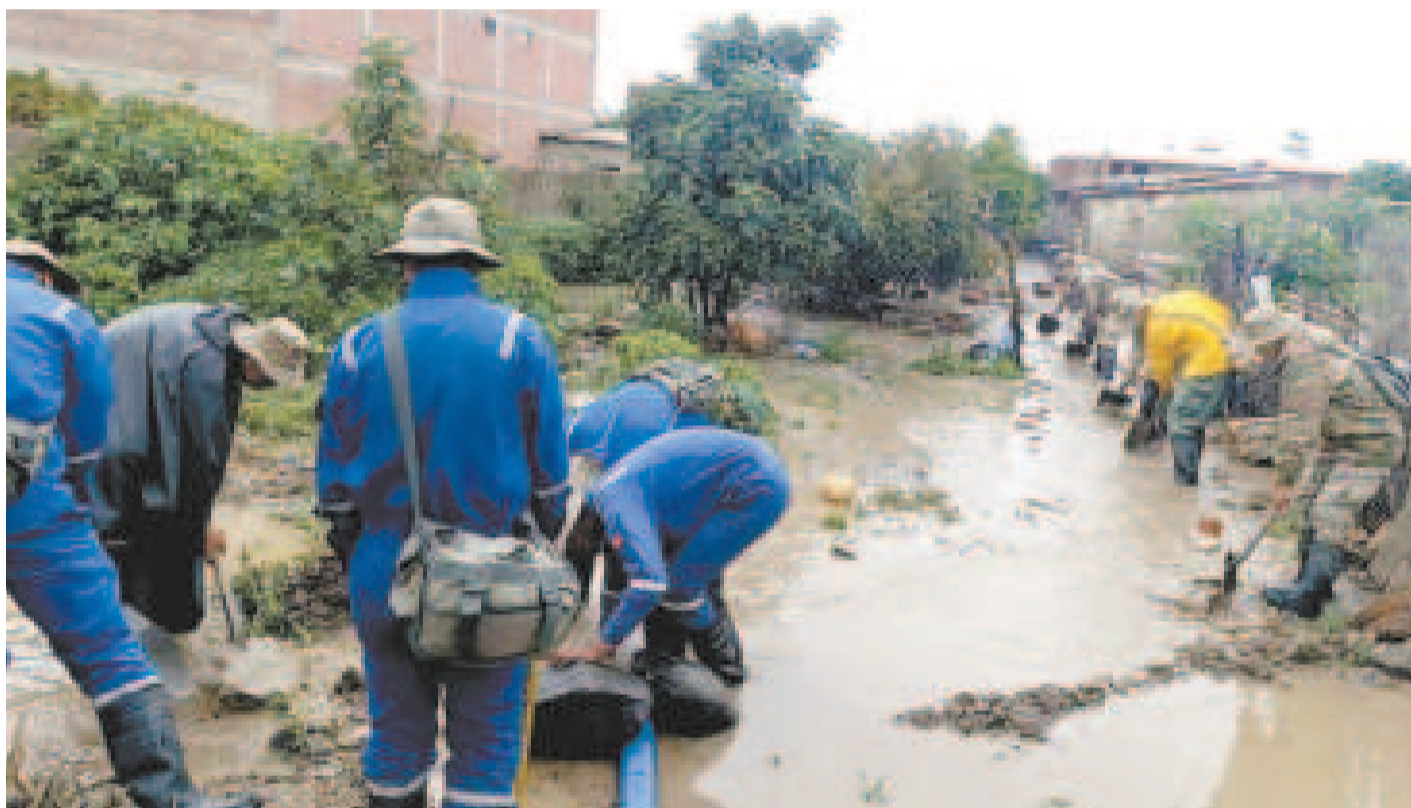
Defensa Civil y obreros en Quillacollo, Cochabamba, trabajan en una zona inundada.
