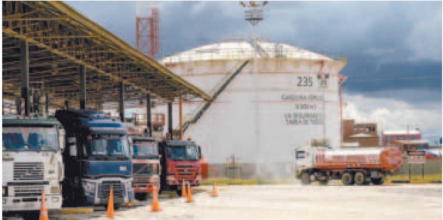
Una planta de almacenaje de hidrocarburos de YPFB.
