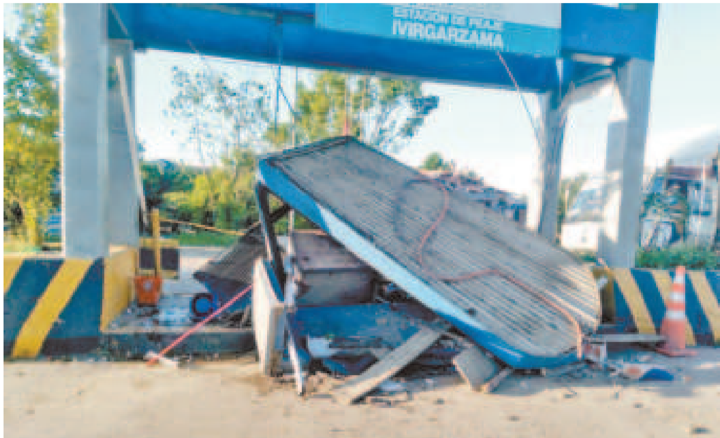
La estación de peaje destruida en Ivirgarzama, Cochabamba.
