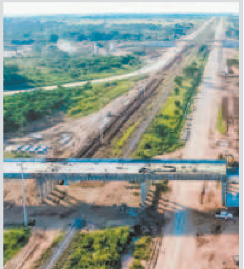
Estado actual de la carretera.
