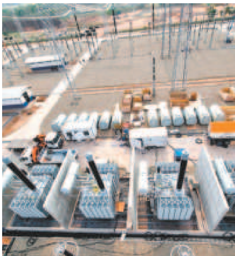
Los equipos de extra alta tensión montados por ENDE Transmisión.
