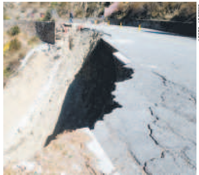
Deslizamiento en la avenida Julio Téllez de Alto y Bajo Tacagua.
